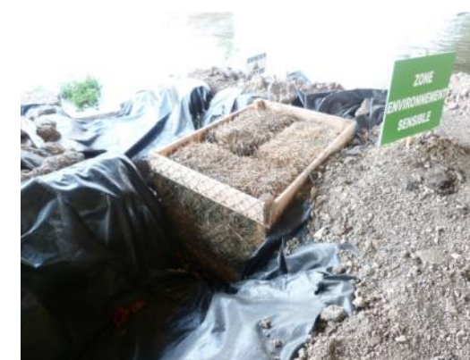
Photo 18 : Exemple de mise en place de filtre avant rejet dans un cours d'eau (source : SETEC)
