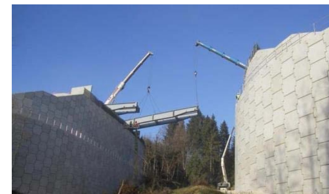
Photo 1 : Exemple de pose à grue d'un ouvrage d'art : PI 161 La Ravoire - A41 Nord (Setec)
