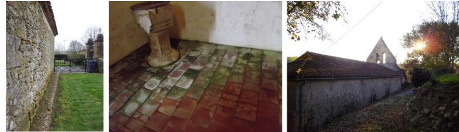
Eau pluviale au pied de l'église de Cazaux / Humidité intérieure / Pose d'une gouttière sur la toiture de la chapelle de Montgaillard.
