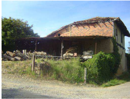
Un bâtiment en mauvais état
