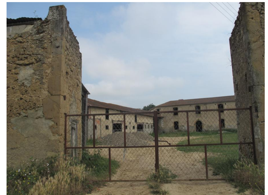
Bâti délabré, secteur Boutigué / Carerots Sud
