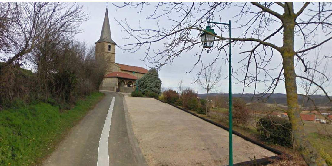
Les aménagements réalisés le long du chemin de crête menant à l'église.
