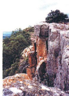
Fig. 28 : Eboulement au sud du Martinet, à côté du moulin en réparation au lieu dit la Rouquette
