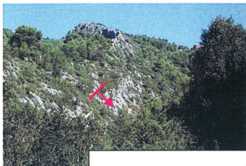
Fig. 37 : Falaise « Notre Dame de Nazareth » : forte potentialité d'éboulement (glissement bancs sur bancs.)
