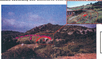
Fig. 26 : Glissements de versant, réactivés lors des travaux de terrassement pour la construction d'une maison (hameau le Tudéry)
