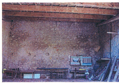
Fig. 42 : Murs fissurés et bombés par suite d'un phénomène de fluage (hameau le Tudéry).
