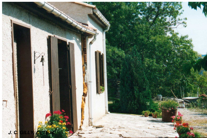
Les Plans janvier 1996, ayant entraîné la déformation et la destruction partielle d'un mur. Une maison située en aval de ce mur a été également affectée. Chemin d'accès à la maison également fissurés. Arrêtés Cat. Nat : juin 96 et 17Juil 97.
