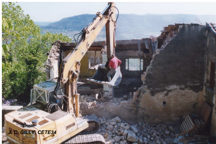
Villeucun : maison expropriée et détruite suite aux désordres subit par le glissement récurrent affectant tout le secteur Nord du village.
