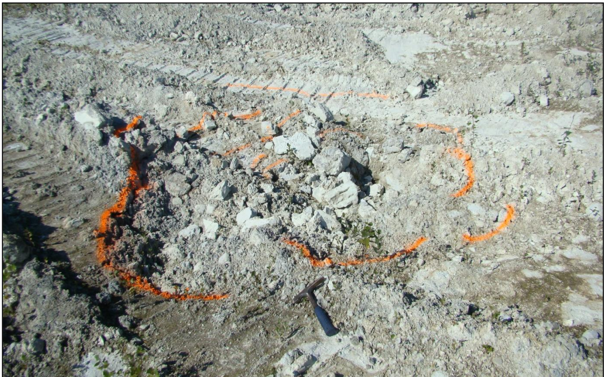
Figure 76 : Fontis en cours de formation dans la partie Sud du site de SOCODAC [Source : IMS RN ]
