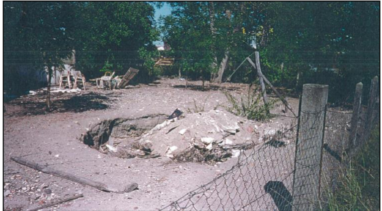
Figure 28 : Fontis en partie remblayé à l'angle du chemin de Cousseillat et de la RD 932 [Source : ANTEA]
