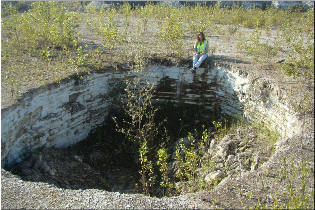
Figure 60 : Fontis d'environ 10 m de diamètre (désordre n° 1 dans l'étude BRGM) [Source : IMS RN ]
