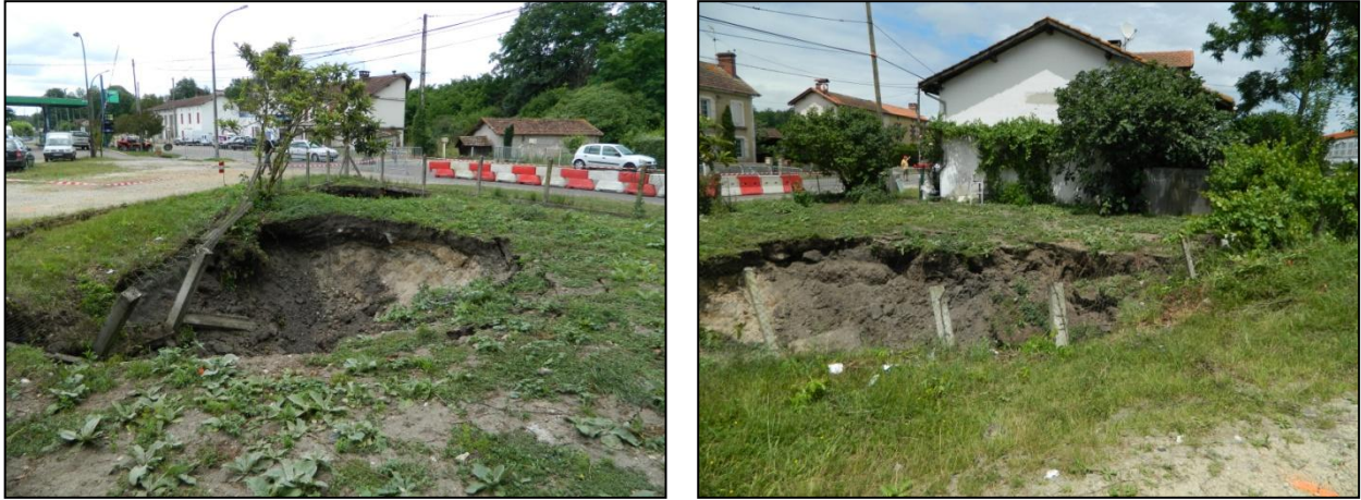
Figure 43 : Effondrements survenus le 6 juillet 2012 à proximité de l'avenue Gaston Lescouzères. Celui au premier plan correspond au premier événement, le seconde est visible en arrière-plan sur la photo de droite [Source : BRGM]
