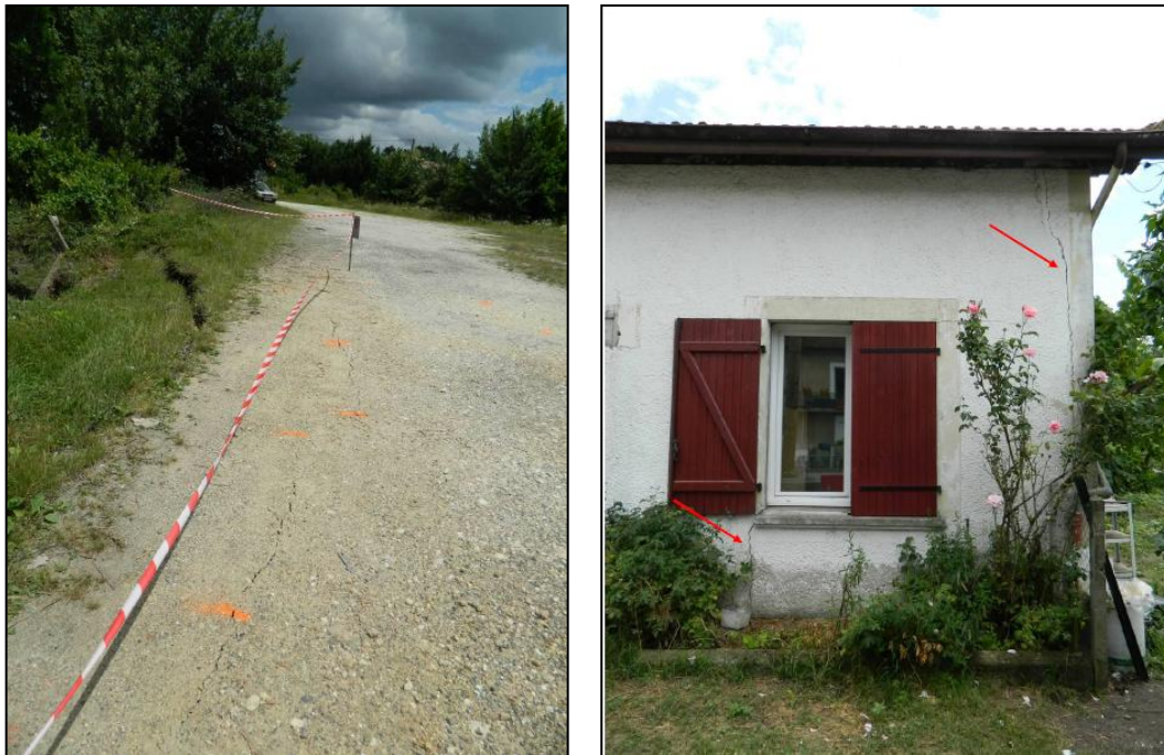
Figure 44 : Fissuration sur un chemin (photo de droite) et sur le bâti (photo de gauche) en périphérie des effondrements [Source : BRGM]
