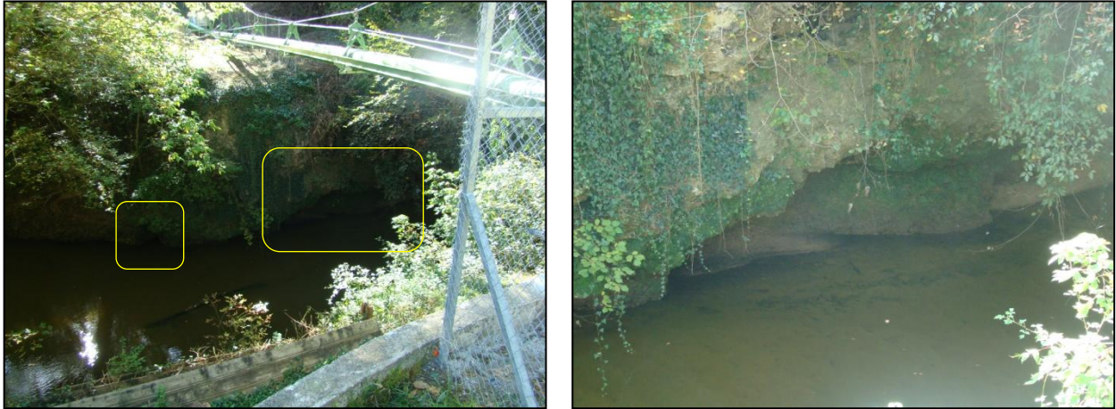
Figure 78 : Cavités et sous-cavages le long de la Douze au niveau de la conduite de gaz suspendue [Source : IMS RN ]
