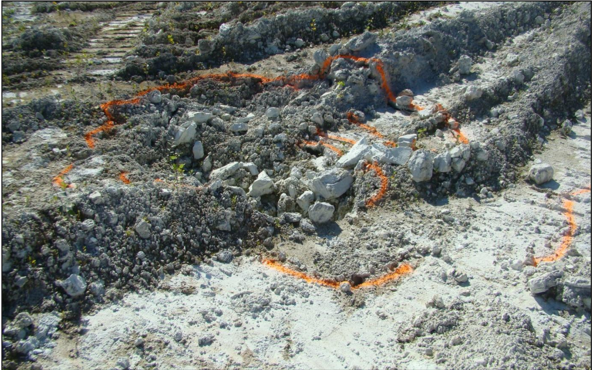
Figure 77 : Fontis en cours de formation dans la partie Sud du site de SOCODAC [Source : IMS RN ]
