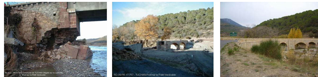
Photo n°14-15-16, Dommages occasionnés par la crue du Petit Verdoube en 1999 sur un pont en amont de Tuchan, et vu du pont reconstruit depuis. (Source : http://www.languedoc-roussillon.ecologie.gouv.fr et Ginger)
