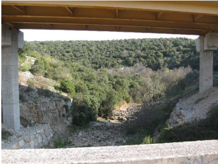
Photographie 34 : Sortie du secteur engorgé du Coulazou
