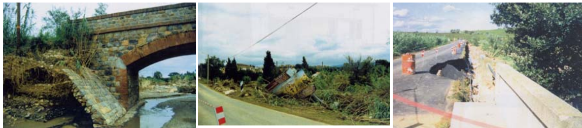
Photos n°6, n°7 et n°8, effondrement RD 615 ; Fourques, endommagement RD23 aux abords du pont ; dégâts sur pont RD2 à Fourques (source : DDE, 1993).
