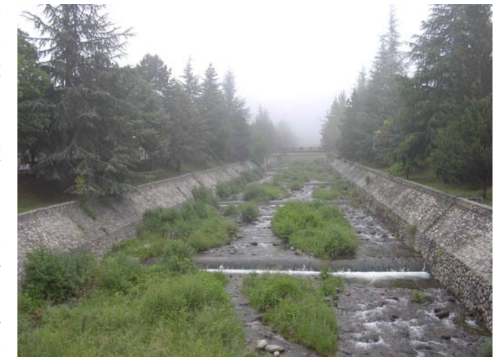
Photo n°19, protections de berges et seuils sur le Cady à Vernet les Bains
